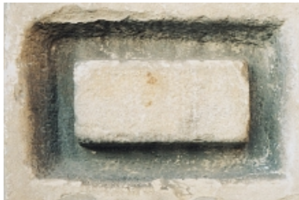
Il mattone di Parma nelle mura dei fabbricati di piazza Garibaldi (foto: Elisabetta Pieri).
